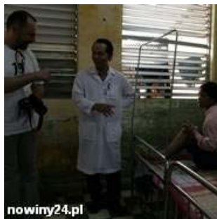
Grzyb na ścianach, tynk sypiący się z sufitu, rolety zamiast szyb - tak wyglądają sale chorych w szpitalu ortopedycznym, gdzie pomagał m. in. lek. med. Wojciech Piwek (na zdj.). (FOT. MACIEJ WILK)
